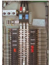
配電内部は危険!
