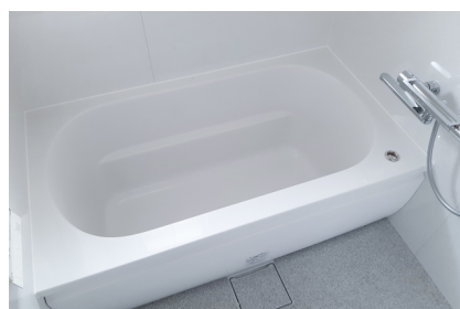
浴場・浴槽の排水
